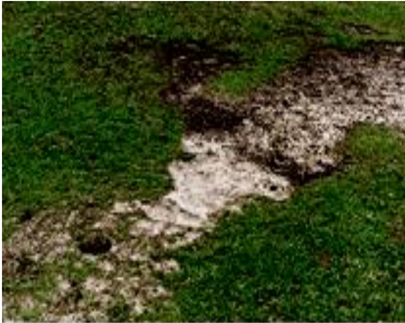
Eroziuni datorate șiroirii apei pe suprafața versantului
